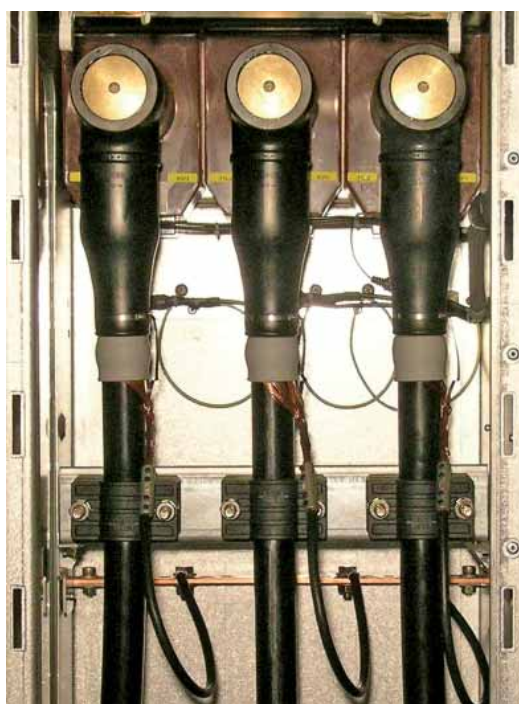
Рисунок 7.6.2: вид спереди внутри отсека кабельных подключений в воздухе, с кабельными адаптерами (ABB – тип SOC 630 ...)
