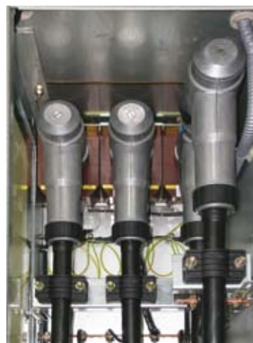
Рис 6.6.3. Вид спереди отсека кабельных подключений в воздушной атмосфере с кабельными штекерами и кабелями (фаза L3 в качестве примера оснащена двумя кабелями)
