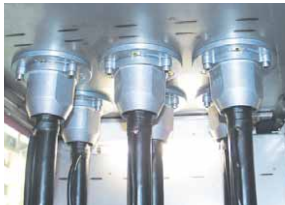
Рис. 7.4.1.1. Вид открытого отсека кабельных подключений с кабельными адаптерами и кабелями
