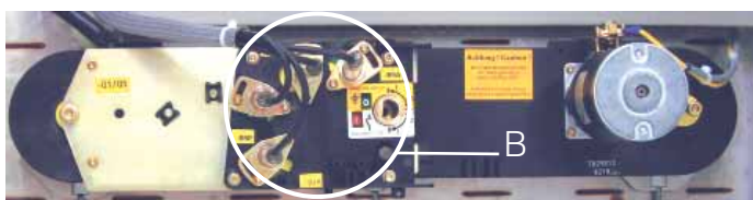
Рис. 7.2.6. Привод трехпозиционного разъединителя с индуктивными бесконтактными датчиками для определения положения выключателя
