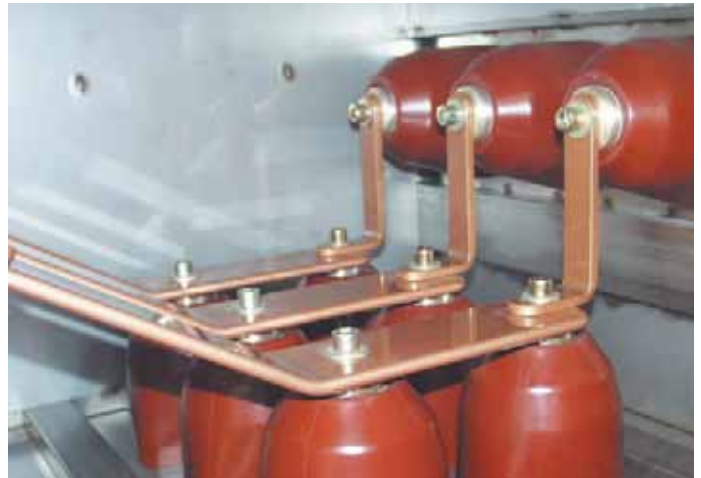
Рис. 7.6.1. Вид на отсек выключателя: испытательные разъемы
