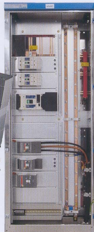
▲ Секция силовых выключателей отходящих линий в модульном исполнении
